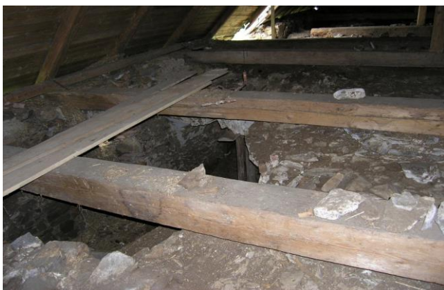
Havarijní stav ovčína před 10 lety
